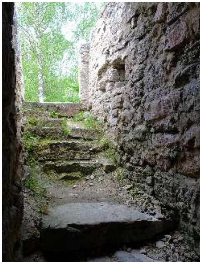
7.fotoattēls. Skats uz esošajām akmens kāpnēm ziemeļu korpusa austrumu galā. Esošie pakāpieni daļēji zuduši, vietām bojāti..
