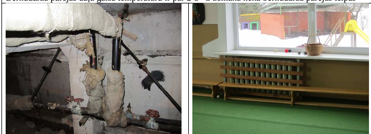
Bērnudārza apkures sadales sistēmas ir izbūvētas pagrabstāvā, savukārt telpās apkure tiek nodrošināta ar čuguna radiatoriem un siltajām grīdām
