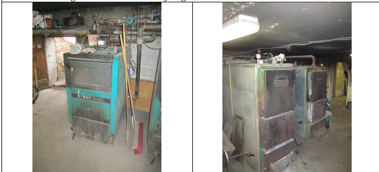
Bērnudārzā ir uzstādīti trīs apkures katli, kuri atrodas sliktā tehniskā stāvoklī ar zemu lietderības koeficientu.
